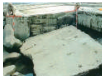
堰の被災事例(エプロン陥没)
