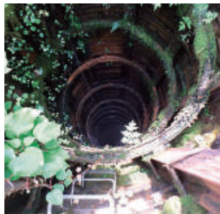
図1 老朽化が進む集水井
