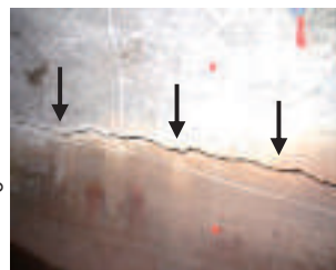
水路トンネルに見られる ひび割れの例
