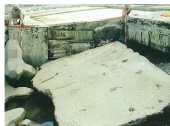
堰の被災事例(エプロン陥没)
