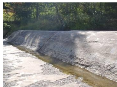
図1 固定堰直下の摩耗の例
