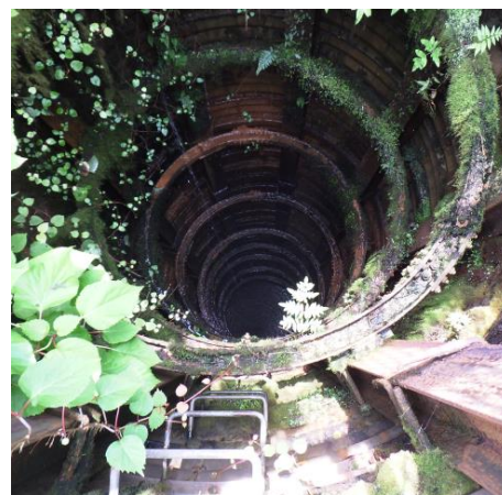
図1 老朽化が進む集水井
