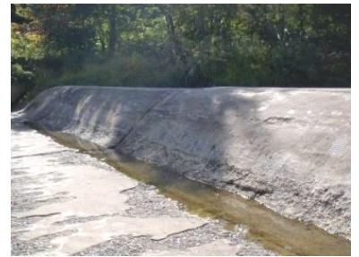
図1 固定堰直下の摩耗の例
