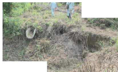
写真1 壊れていたU字溝と侵食された農道。ここから集水域の地表流出水が盛土部へ流れ込む環境にあった。
