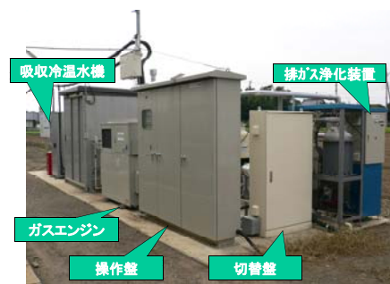
トリジェネレーションシステム
