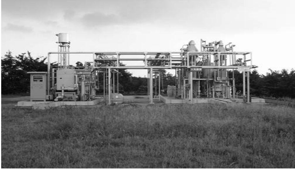
図1 バイオディーゼル燃料製造試験装置全景
