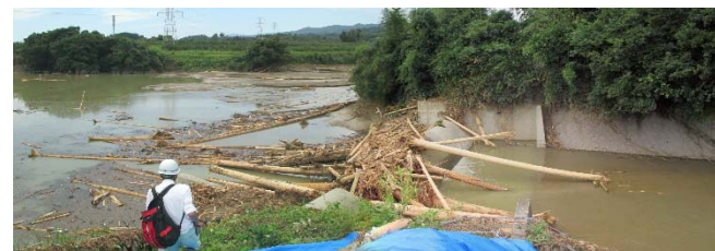
崩壊した洪水吐(Aを矢印方向から撮影)
