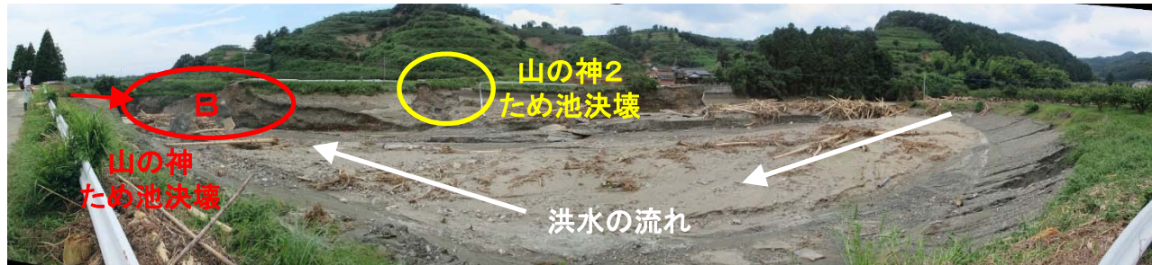
山の神2ため池の決壊と土砂が流入した山の神ため池の貯水池 (Aを矢印方向から撮影)
