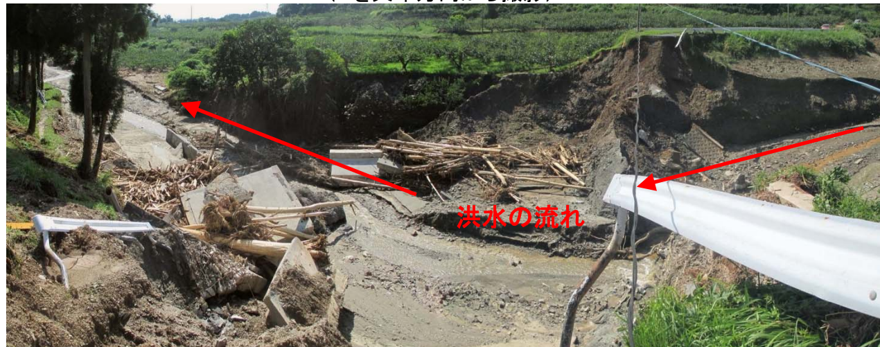
決壊した山の神ため池の堤体(Bを矢印方向から撮影)
