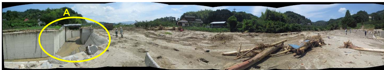
土砂が流入した梅ヶ谷1ため池の貯水池(上流から)
