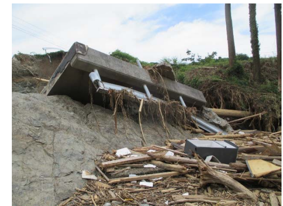
下流に流された洪水吐の橋梁部 (Cの部分に存在した)
