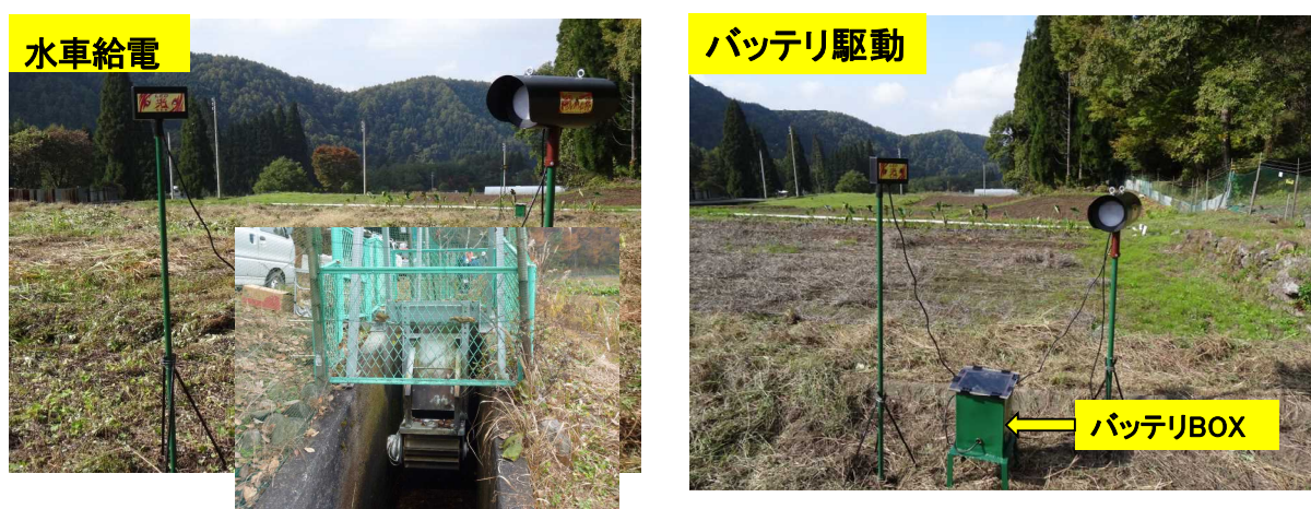
図7 現地に設置した獣害防除機の様子
