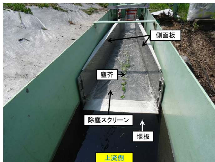
図6 農業用水路に設置した除塵装置
