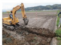
①小型バックホーで暗渠上下流端（水閘部、通気孔部）を掘削します。
