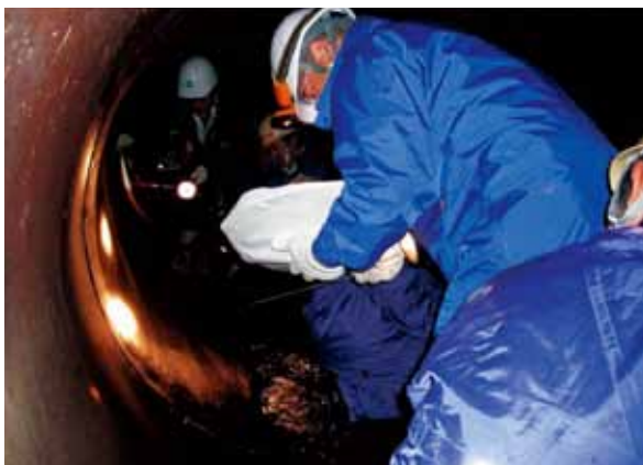
■2008年岩手・宮城内陸地震で被災した幹線のパイプライン内部の点検
