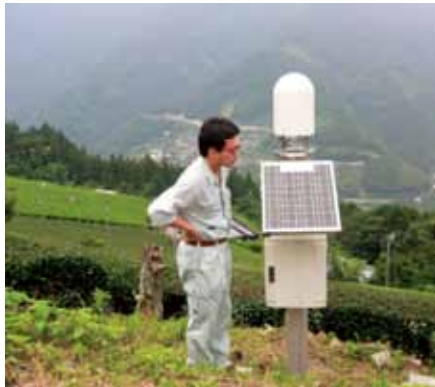
■GPS地すべり変位観測システム
