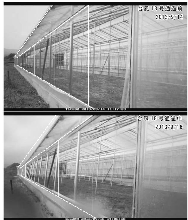
写真3 台風18号の強風による変位（上写真：2013年9月14日11：17，下写真9月16日14：06）
