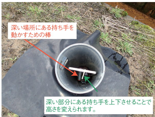
図35 真上からみた水位制御器
