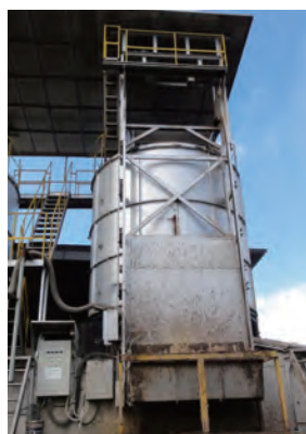
写真1 密閉縦型堆肥化装置 全景
