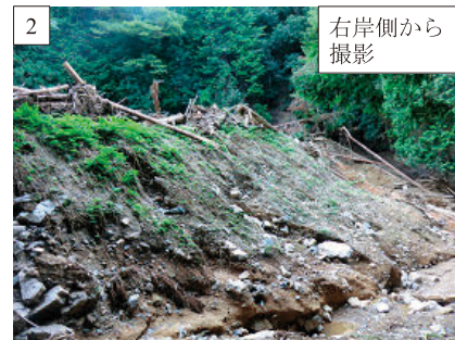
Fig. 22 ⑦池の侵食された下流法面 Eroded downstream slope of ⑦ ike
