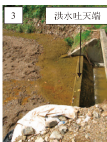
Fig. 14 ③池の洪水吐天端まで達した土砂 Sand and mud above spillway of ③ ike
