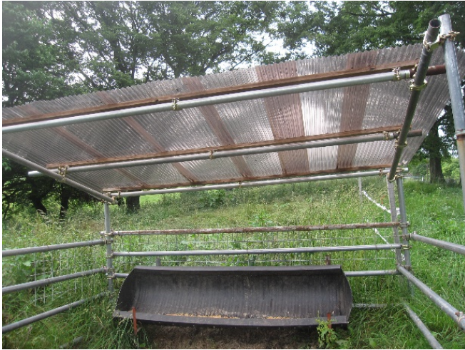
図 2132-3 波板を用いた雨よけ屋根
