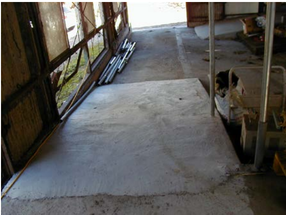
作目： 酪農、畜産 作業： 圃場・施設管理 目的： 施設整備 方法： 畜舎の段差へスロープを設置。
