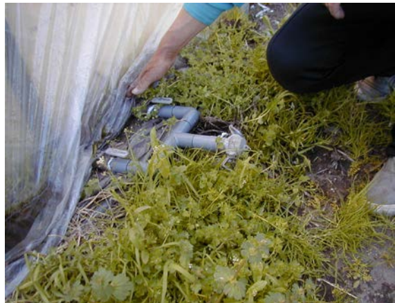
分水栓への連結部分
