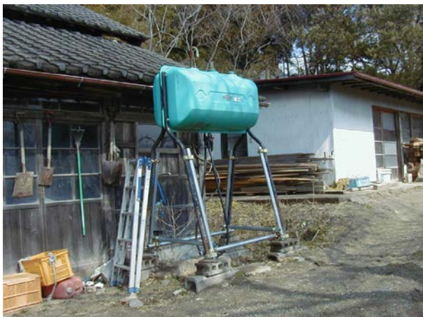
かさ上げた燃料タンク
