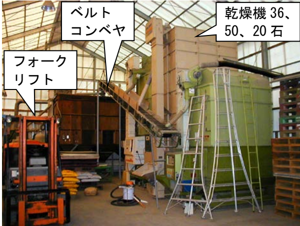
乾燥調整施設
