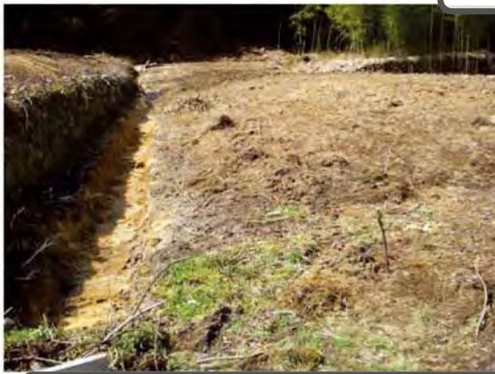
園地の傾斜上部からの排水も重要
