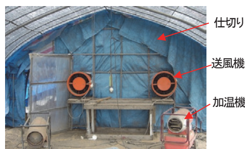
図 7 温風調整室の設置例
