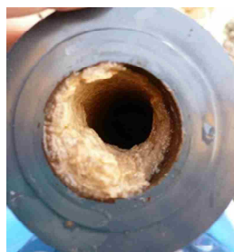
図2 狭くした配管 (2号機)
