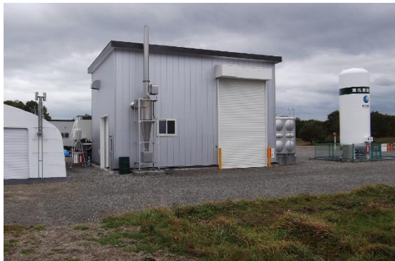
木質チップボイラー
