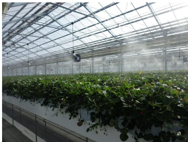
ヘッタータイプ細霧冷房
