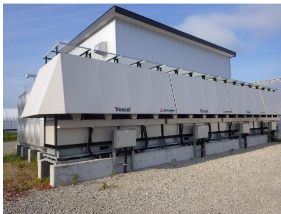
ヒートポンプ
