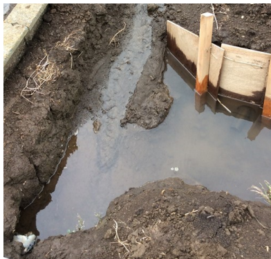
集水穴から排水路に排水
