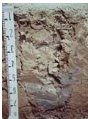
暗渠疎水材の分解による断面積の縮小、排水不良
