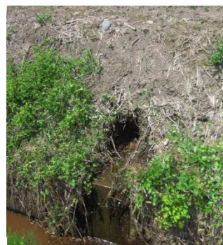
排水路の穿孔部
