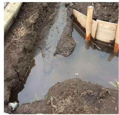
集水穴から排水路に排水
