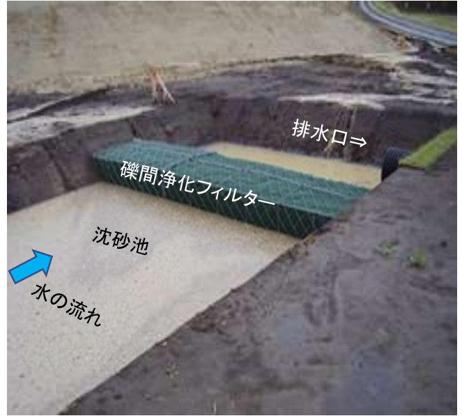
沈砂池による濁水流出抑制
