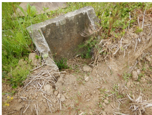
× 流出土で詰まった落水口
