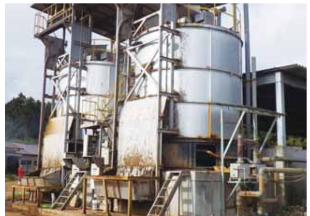
▲ 家畜ふん堆肥の発酵熱を回収・利用する装置の現地実証施設 (栃木県那須塩原市の酪農家にて)
