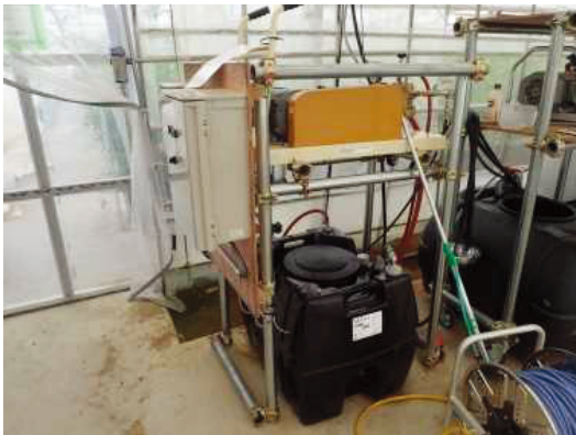
高圧ポンプ、水タンク
