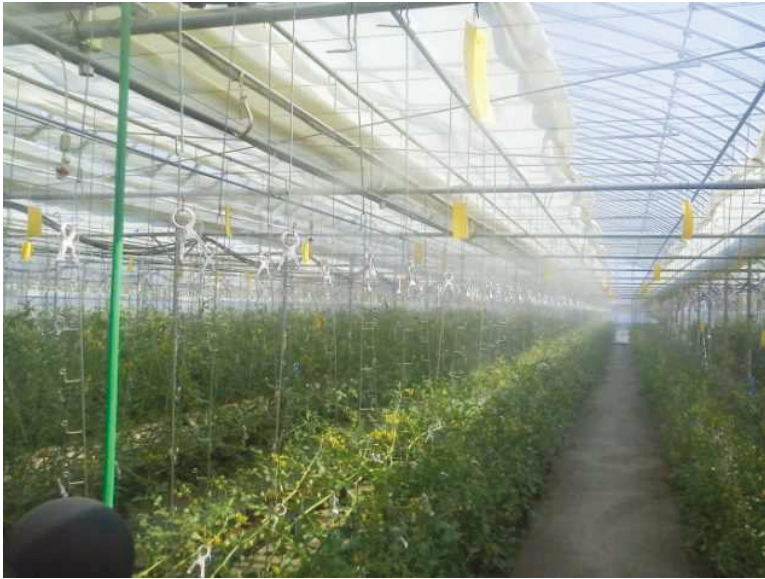
遮光を併用した細霧冷房の稼働状況
