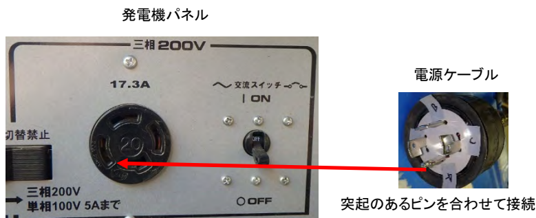
図 4.8 発電機と電源ケーブルの接続
