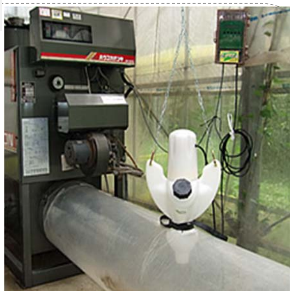
ダクト内自動投入機
