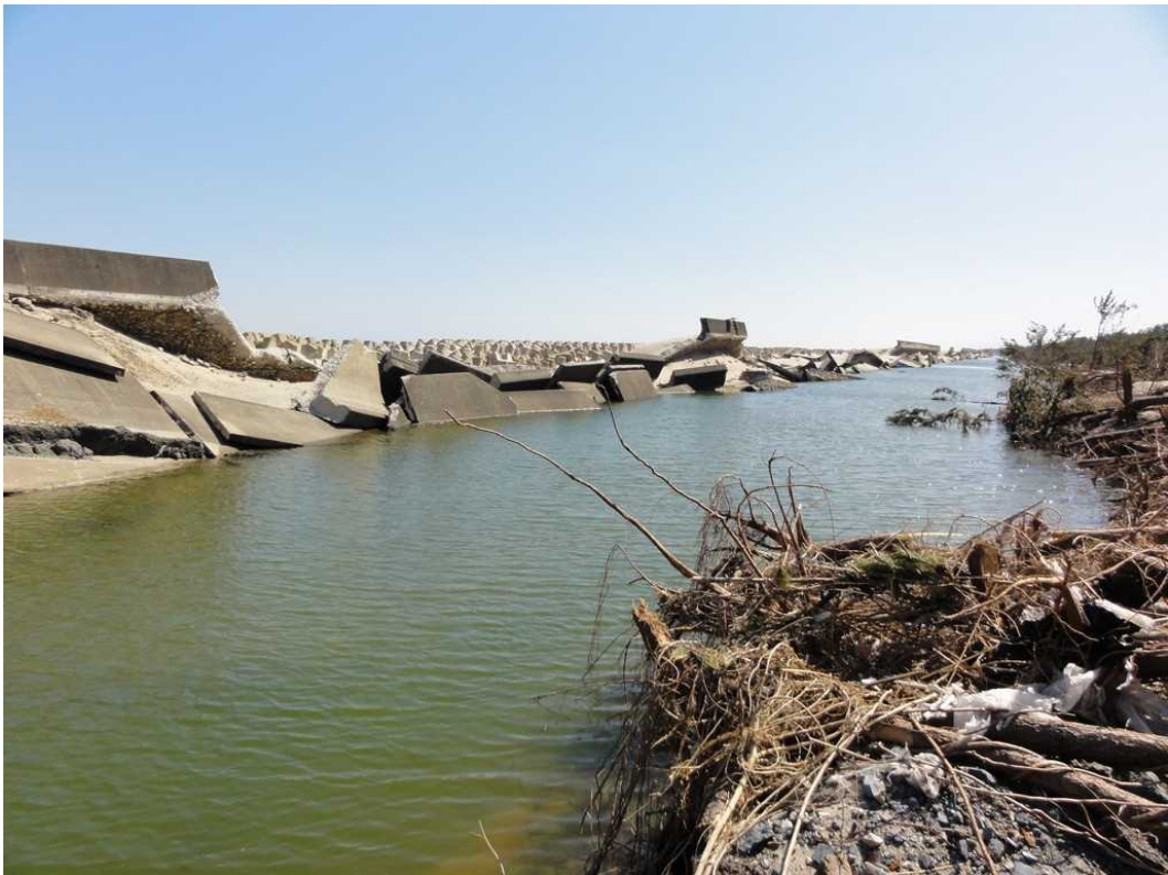
東日本大震災による海岸堤防の被災状況（宮城県亙理町）
