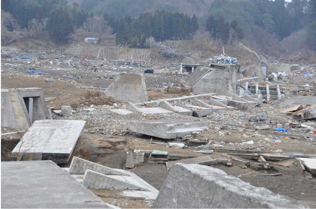
東日本大震災による海岸堤防の被災状況（岩手県田老町）
