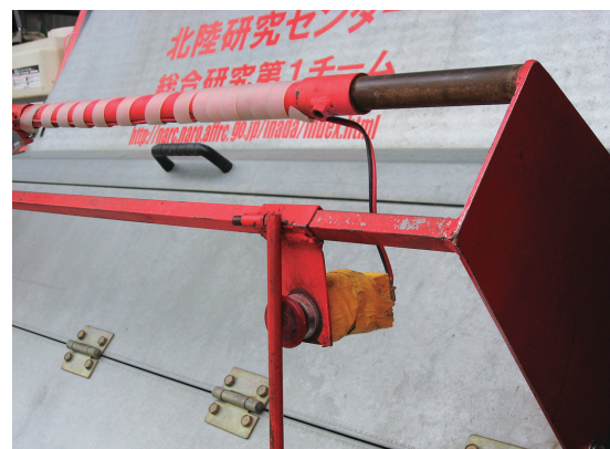
押しボタンスイッチの取り付け状態
