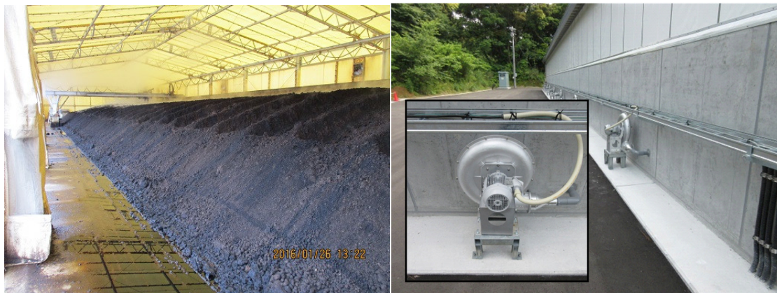
図 5-15 一次発酵槽(左)と通気設備 (右) (遠矢原図)
