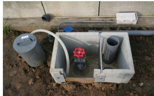
FOEASの用排水ボックスへの設置状況
