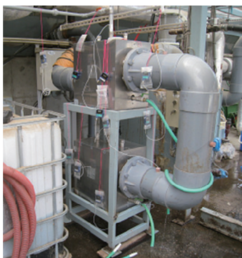
写真 3 A 牧場に設置された吸引 通気方式用の熱交換器
