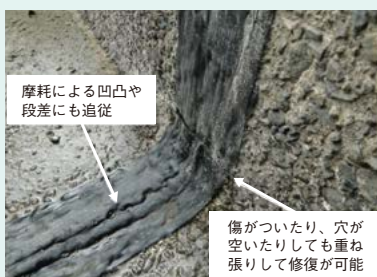
図2 通水後の漏水補修テープの外観
