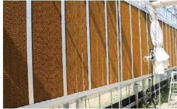
パッドアンドファン※(パッド部)
