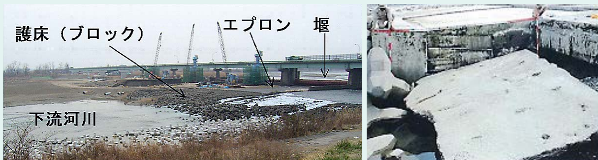
図1 河床低下で護床が急傾斜化した取水堰（左）と堰の損壊例（右、エプロン陥没） 1)
