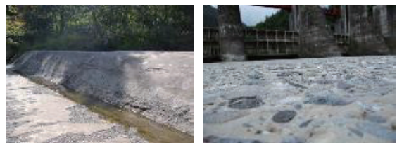
▲図1 頭首工の摩耗状況(左:固定堰、右:エプロン)
