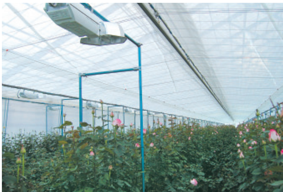
二酸化炭素施用を行って栽培しているバラ温室
