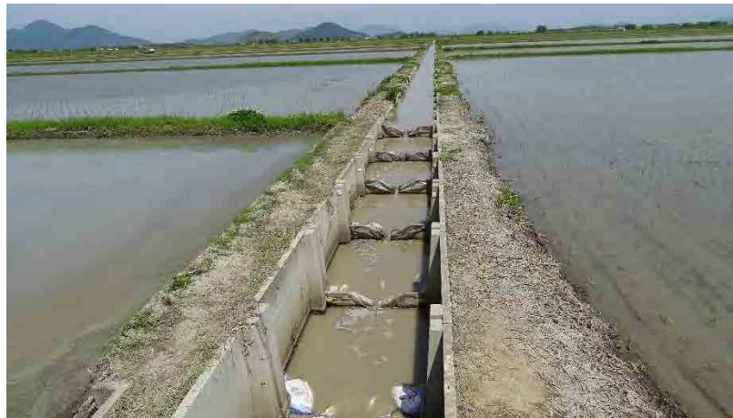
図 63. 排水路を堰上げした魚道
