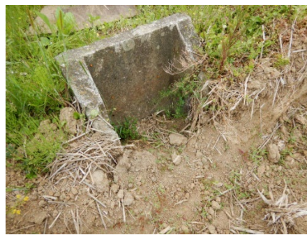
× 土砂で詰まった排水口
