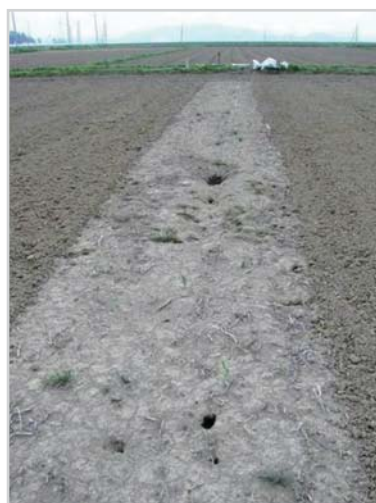
暗渠空洞化による田面の陥没
