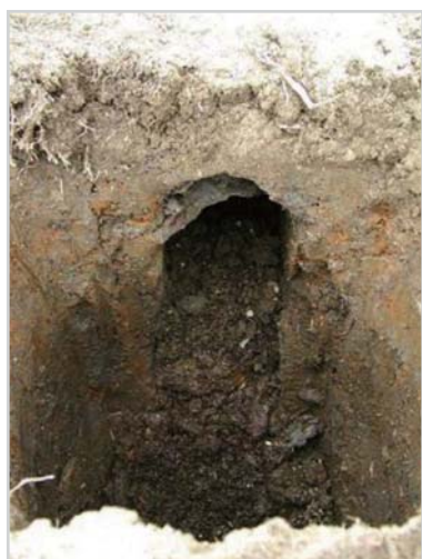
もみ殻疎水材の腐植による暗渠の空洞化
