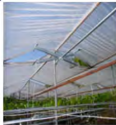
▲天井ビニールの自動開閉装置 (2014年 研究所開発)
