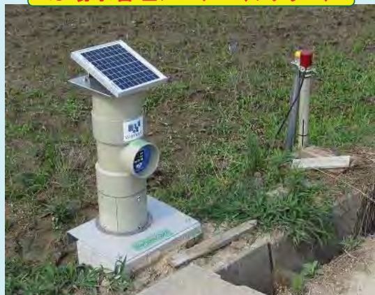
ほ場水管理システム(ワタラス)
