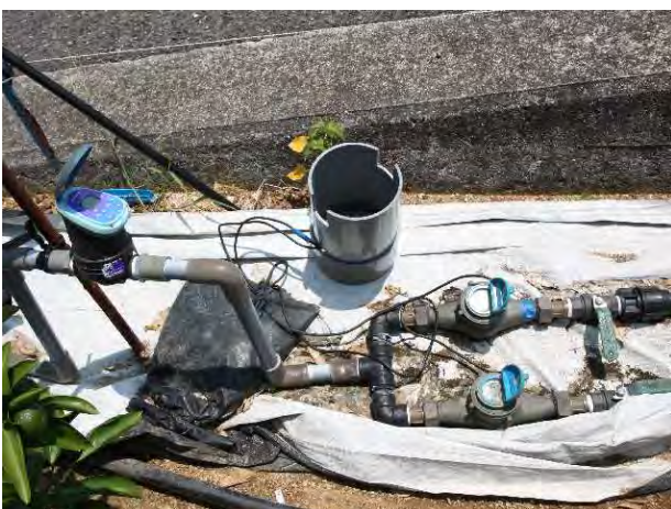
写真VI-3-5 園地との接続部分 注：水や液肥は、右から左へ流れている
