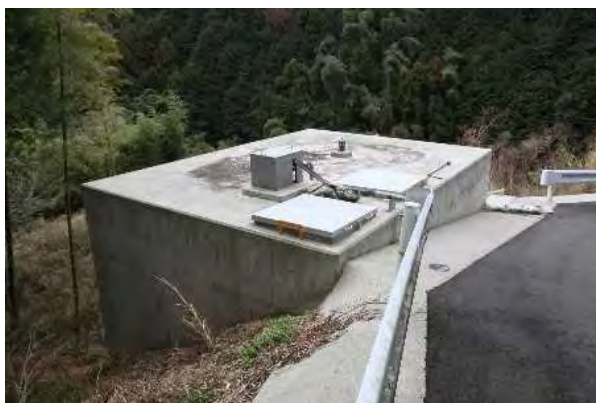
写真VI-4-1 水源の貯水槽
