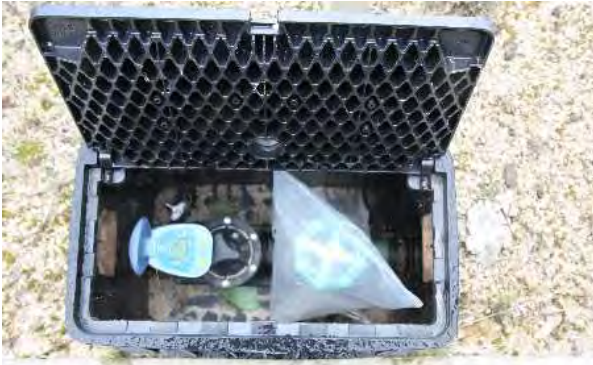
写真VI-4-3 各園地に設置された電磁弁
