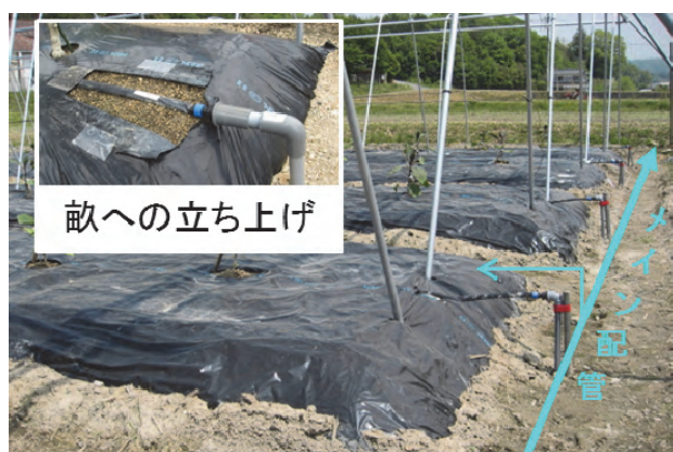
メイン配管から畝への立ち上げ
