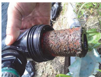
フィルターの汚れ
