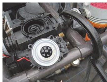
電磁弁の詰まり
